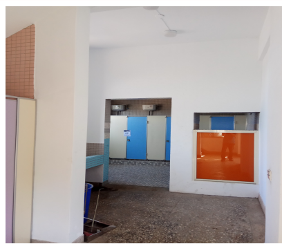
機械科一館 1 樓西側廁所
